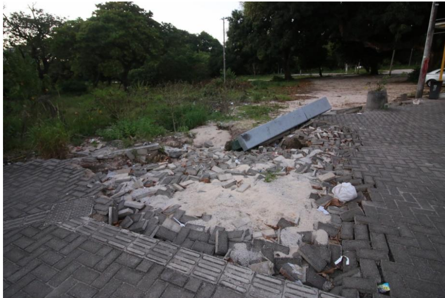
Figura 16 - Calçamento e bancos quebrados e de iluminação precária no Parque da Lagoa da Maraponga, Fortaleza-Ce.
